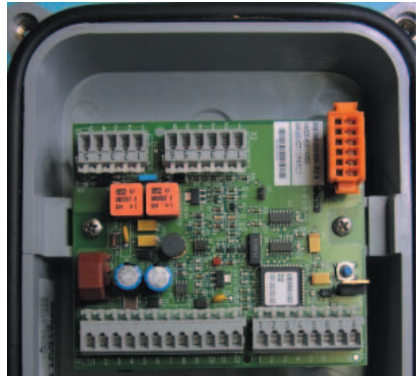
Bild 3: Baugruppe ESD im Kabelverteiler
